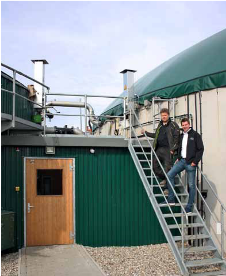
Henrik Snethkamp, links, und Frank Steenken auf der Treppe, die auf das Dach des Technikraums führt. Oben sind die Über-/Unterdrucksicherungen und die Bullaugen gut erreichbar.
