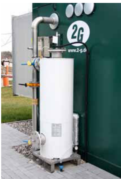
Externe Entschwefelungskolonne vor dem BHKW-Container auf der Biogasanlage Snethkamp.
