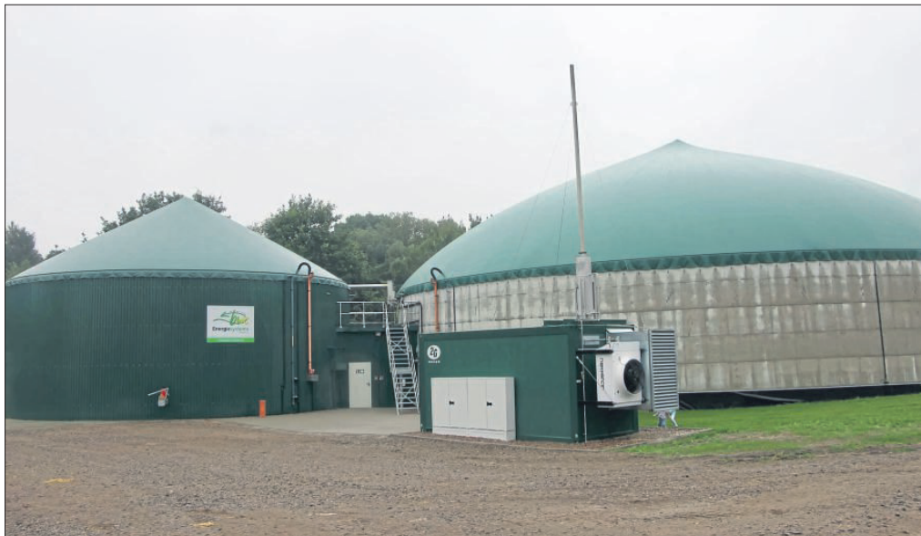
Seit dem 4. Februar dieses Jahres ist die Biogasanlage auf dem Hof von Thomas Kamphake und Anna Kastens in Ströhen in Betrieb. „Gefüttert“ wird sie mit Rindergülle und Festmist. Das erzeugte Gas wird in Strom umgewandelt, dieser wird ins Netz eingespeist.
